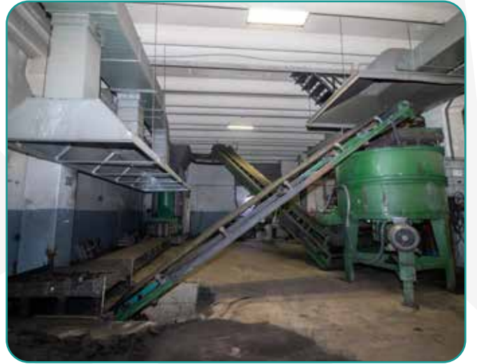
Yaş Kum Dönüşüm Tesisi: 1saat/18 Ton Kapasiteli Yaş Kum Dönüştürmektedir. Wet Sand Conversion Plant: 1hour/18 Tonne Capacity Wet Sand Converting Plant
